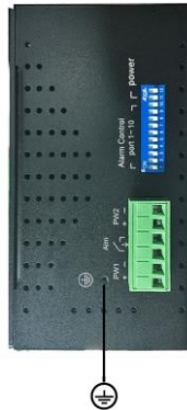
Рис.7 Заземление коммутатора SW-80822/IR
