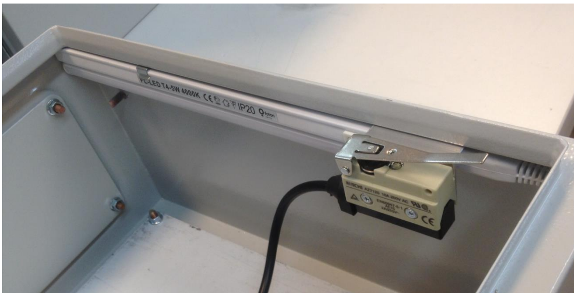
Рис.3.2.9-2 Установленные выключатель вскрытия и светильник.
